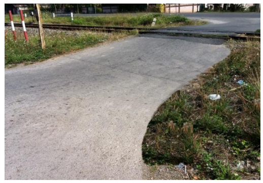
รูปที่ 7 สภาพเครื่องหมายจราจรบนพื้นทางชำรุดหลุมร่อน
