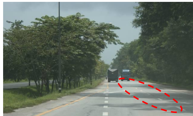
รูปที่ 6 ไม่มีป้ายบอกกรวดังสวนทางและกรวยแบ่งช่องทางจราจร บริเวณทางเบี่ยง บ้านมดแดง อ.เวียงสระ จ.สุราษฎร์ธานี
